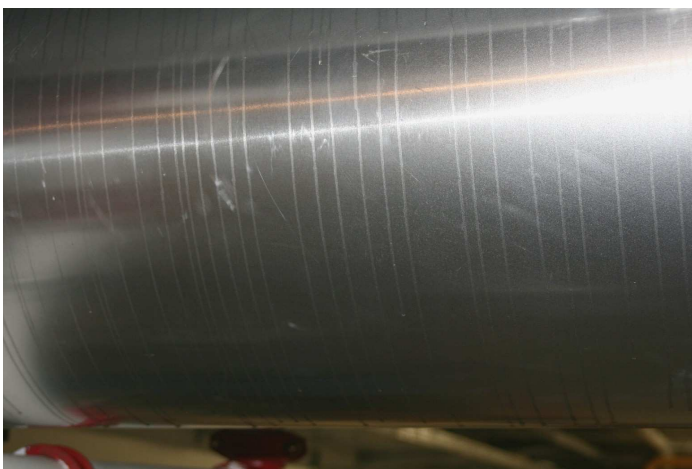
Bild 2: Starke Ölablagerungen auf einem Lüftungsrohr
