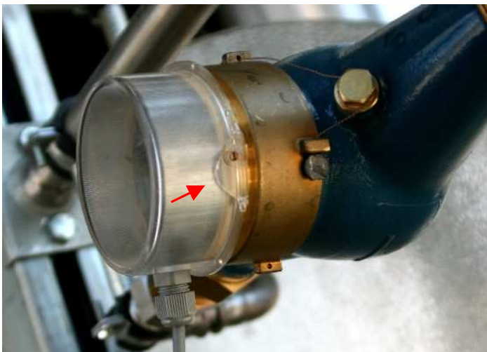
Bild 4: Angerissene Abdeckung einer Wasseruhr
