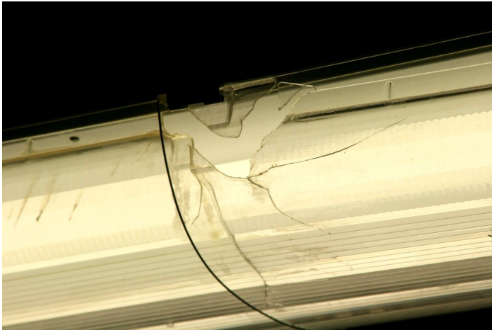
Bild 3: Gerissene Abdeckung einer Neonbeleuchtung
