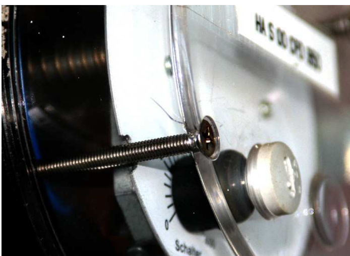
Bild 5: Riss in einer Abdeckung eines Schaltelementes
